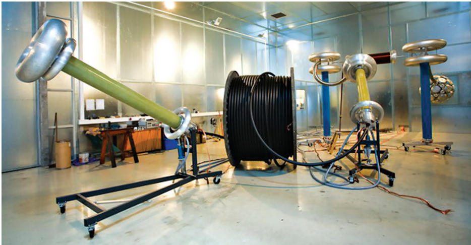
Испытательная станция HIGH VOLT
